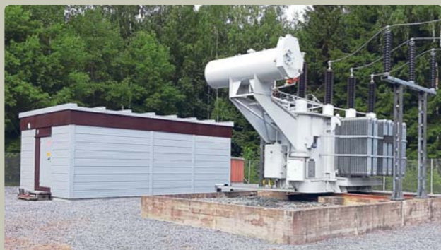
Renoverad transformator vid Karvsor elstation. Karvsorin sähköaseman kunnostettu muuntaja.
