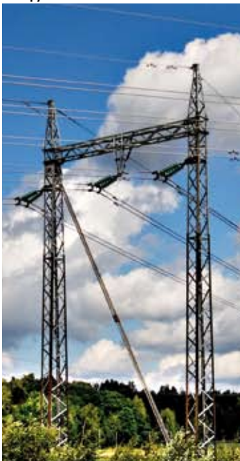
Harustettu kaksijalkainen teräspylvä
